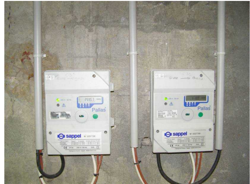
Intégrateur d'énergie des différents bâtiments
