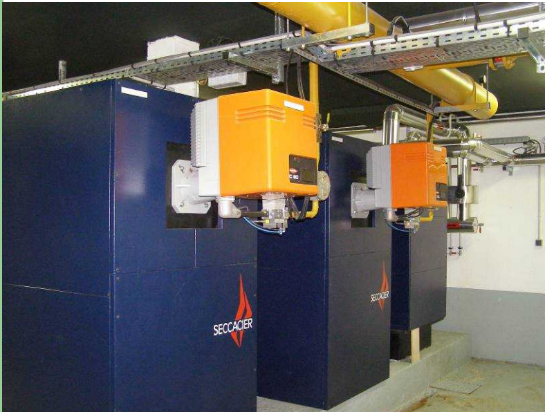
Chaudières à condensation existantes
