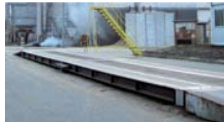
Basculé hors sol.
