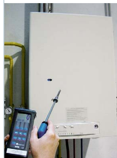
Mesure de CO à proximité d'une chaudière gaz murale de type B11BS
