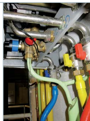
Exemple de soupape de sécurité défectueuse
