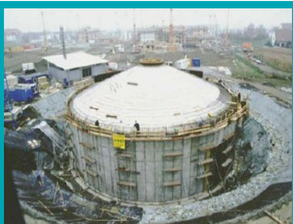
Cuve de stockage du réseau de chaleur de Friedrichshaffen (Allemagne)_Source : Eurosun 2004
