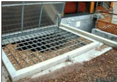
Protection sur la trémie du silo de l'hôtel La Fischhutte à Mollkirch (67)
