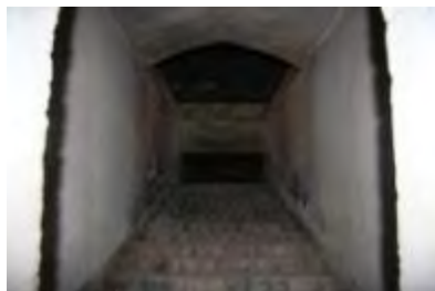
Figure 15 : Briques réfractaires de la chambre de combustion (foyer à grilles mobiles)
