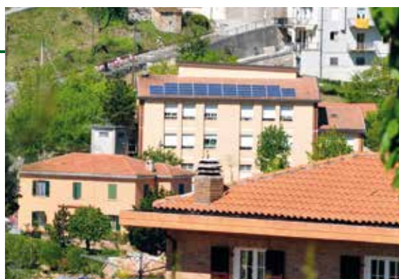
Toiture photovoltaïque sur un établissement public (Italie)
