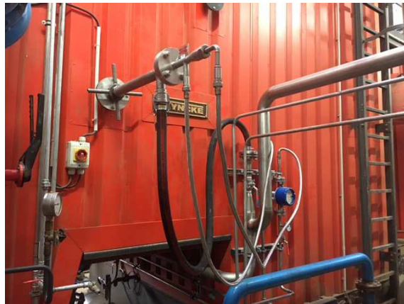
Chaudière bois B 8 MW
