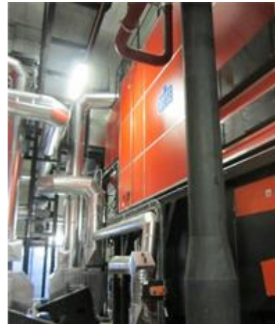
Vue de l'intérieur de la chaufferie
