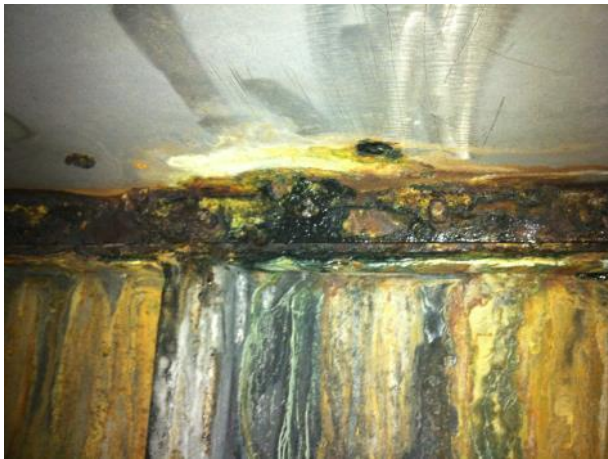
Remplacement scierie Van Roje, condenseur à tubes, presque 2 ans, combustible difficile.
