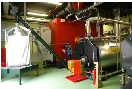
La chaudière bois (arrière-plan) et les chaudières fioul d'appoint / secours (premier plan)
