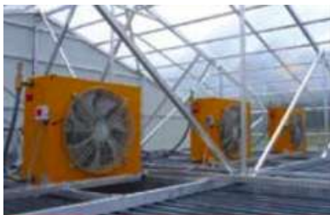
Le capteur solaire et les échangeurs installés sur le toit
