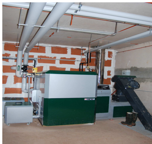
Photo 1 : Vue intérieure de la chaufferie bois
