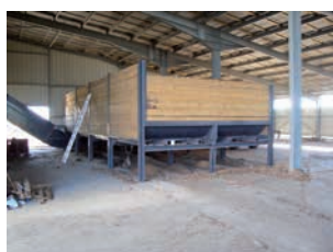
Silo relié à la chaudière
