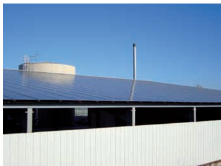
Toiture du hangar de stockage en photovoltaïque
