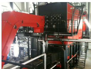
Photo de l'installation
