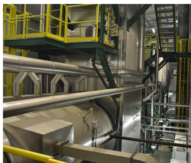
Chaudière SIL – site SAIPOL à Lezoux
