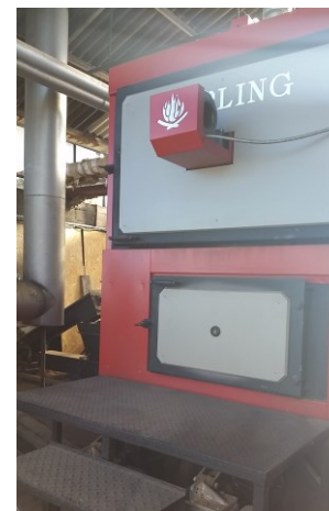
Chaudière à bois déchiqueté
