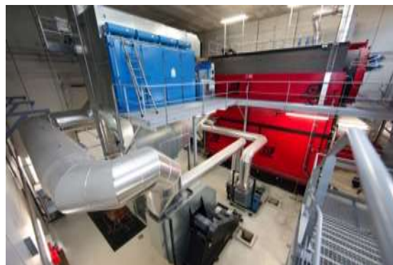
La chaufferie bois de 7,7 MW du quartier de La Gauthière
