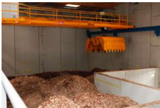
Le silo de 980 m 3 est équipé d'un grappin.
