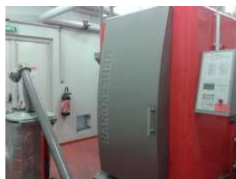
Chaudière bois de 200kW avec cendrier déporté.
