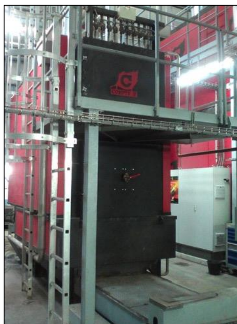
La chaudière de L'Aigle présente un taux de couverture biomasse de 86%.
