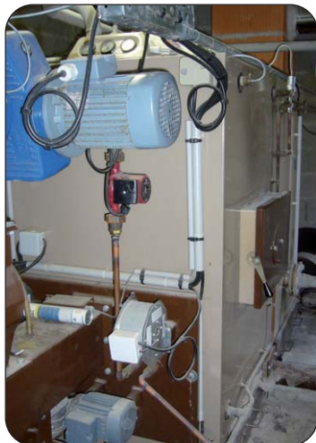
La chaudière bois de 200 kW
