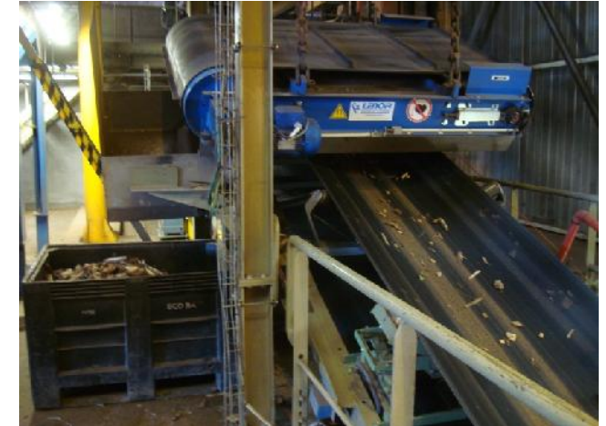
Exemple déferrailleur « over-band » sur convoyage biomasse (cogénération biomasse avec chaudière 25 MW PCI) (photo JMB - 2016)
