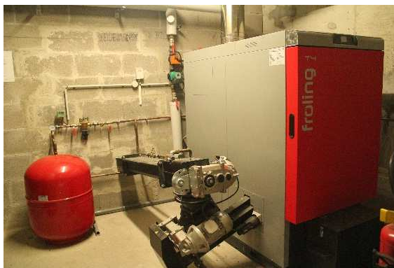
La chaudière de 110 kW alimente la médiathèque et l'école.
