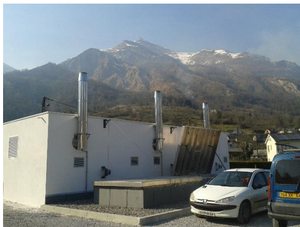
Chaufferie bois énergie de Laruns
