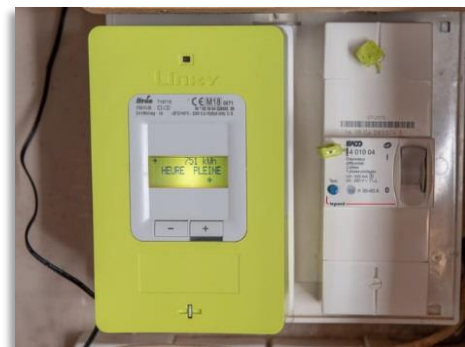
Compteur électrique Linky
