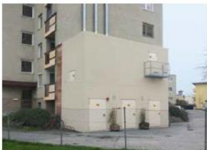
Exemples de chaufferies en contenair
