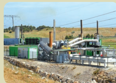
Installation de production de biogaz Septèmes les Vallons (13)
