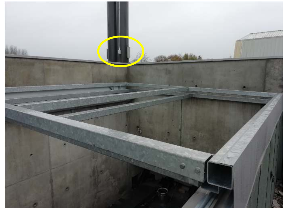
Chaufferie bois Bourbriac – source Inddigo
