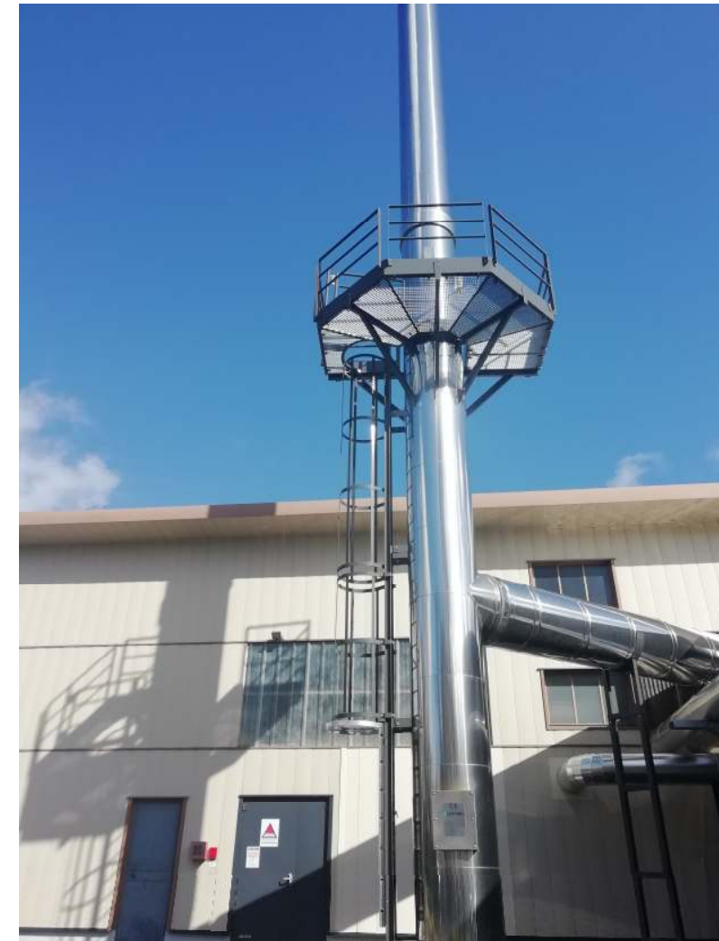
Exemple d'échelle et passerelle – chaufferie de Laval
