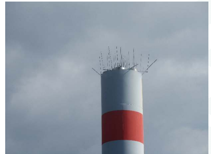
Exemple de paratonnerre – chaufferie de Cernay
