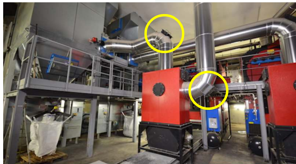
Chaufferie bois Martigues – source Bioénergie Promotion
