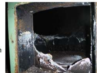
Photos 37 et 38 : Face interne à la base du conduit 1 – mauvais état, effritage de l'acier
