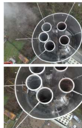
Photos 30 et 31 : Renaisse métallique – déformation et ovalité de la renaisse
