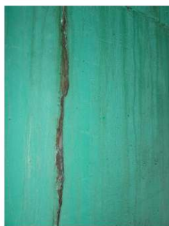
Photos 14 et 15 : Face externe à +13m – fissure verticale sur 9m
