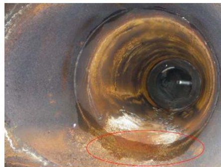
Photos 24 et 25 : Face interne du cameau horizontal – corrosion de surface et rétention de condensats
