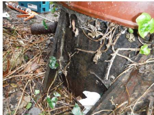
Photos 16 et 17 : Base de la cheminée - corrosion avancée
