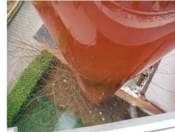
Photos 6 et 7 : Face externe à +10,5m - bon état visuel de la protection calorifuge
