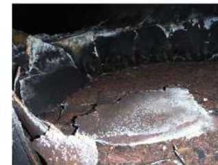
Photo 51 et 52 : Intérieur des conduits en partie haute – bon état visuel de l'isolation thermique
