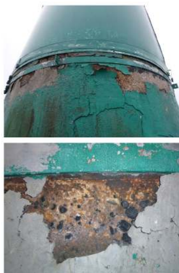
Photos 22 et 23 : Face externe à +30m – dégradation du béton
