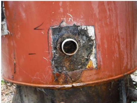
Photo 13 : Tuyauterie d'évacuation des condensats - corrosion
