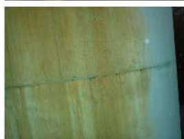
Photos 8 et 9 : Face externe en partie basse – vieillissement de protection vieillissant
