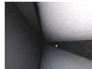
Photos 58 et 59 : Face externe des conduits en partie basse – bon état visuel
