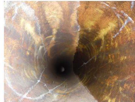
Photo 20 : Face interne depuis le sommet – corrosion de surface
