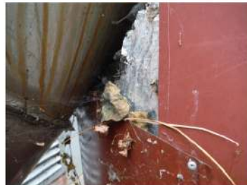
Photos 14 et 15 : Piquage carreau - mauvais état de l'isolation thermique, infiltration d'eau
