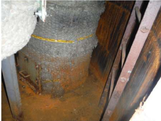
Photo 39 : Base du conduit 2 – mauvais état, calamine avec perte d'épaisseur
