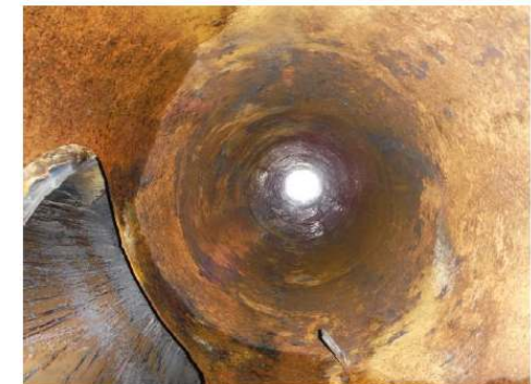
Photos 22 et 23 : Face interne en partie basse - corrosion généralisée
