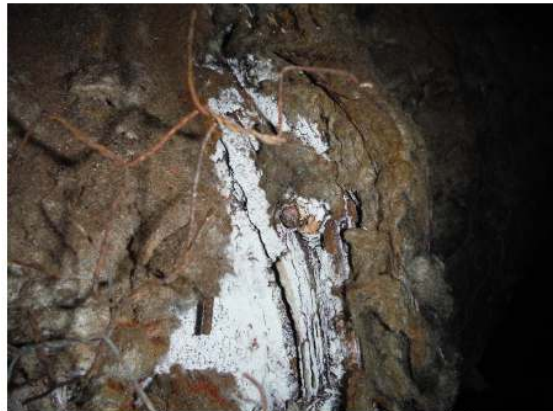
Photo 40 : Bride d'assemblage carneau/conduit 3 – mauvais état
