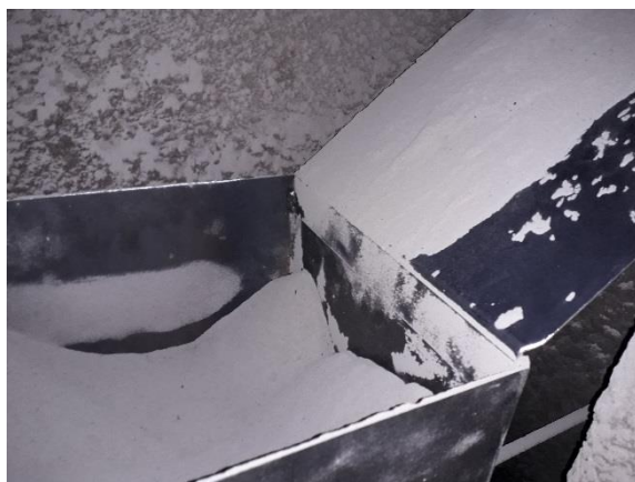
Photo 8 : Bac après la période production (environ 2 heures) après l'arrêt de la chaudière biomasse
