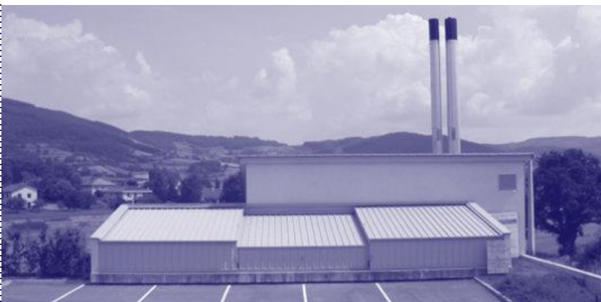
La chaufferie de Tramayes et son silo à bois © Frédéric Douard
