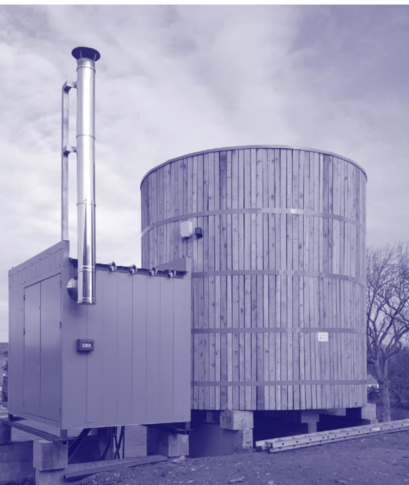
La Micro CHAUfferie COLlective de Zudausques (900 habitants) de la SCIC énergies citoyennes ©Parc naturel des Caps et marais d'Opale
