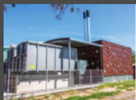
Chaufferie d'Estagel (source : Bois énergie 66)
