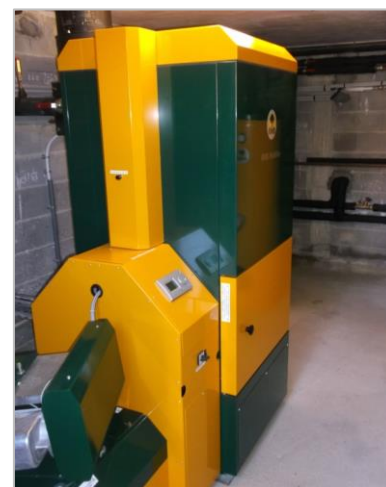
Chaudière bois de marque KWB - 100 kW
