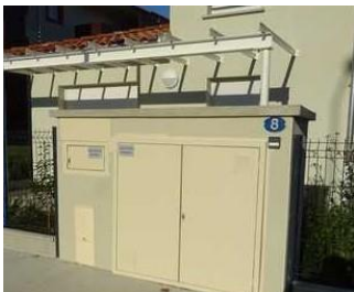
Sous-station maison individuelle
