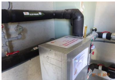
Echangeur réseau de chaleur / réseau immeuble résidence été
