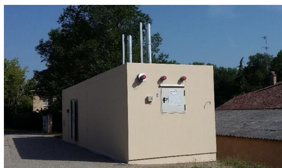
Module chaufferie silo
