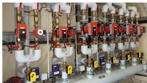
Départ du circuit d'eau chaude
