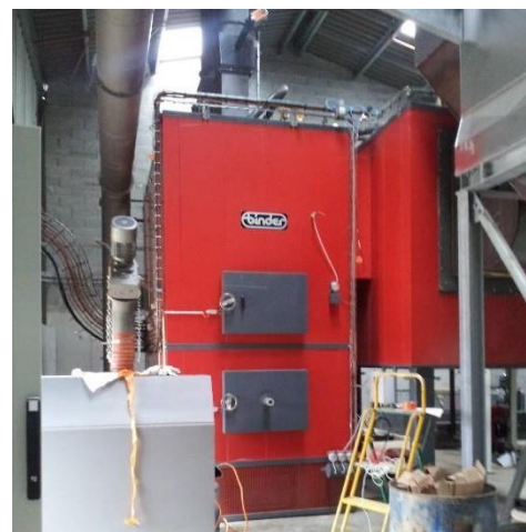
Chaudière de puissance 2,5 MW
