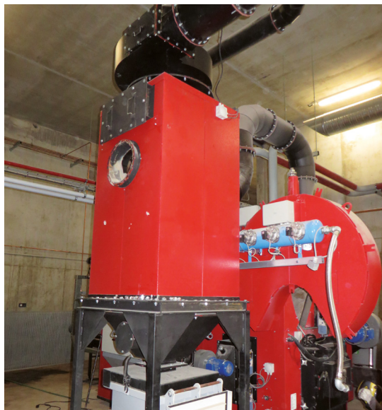
Figure 17 : Multicyclone (Centre aquatique de Libourne)
