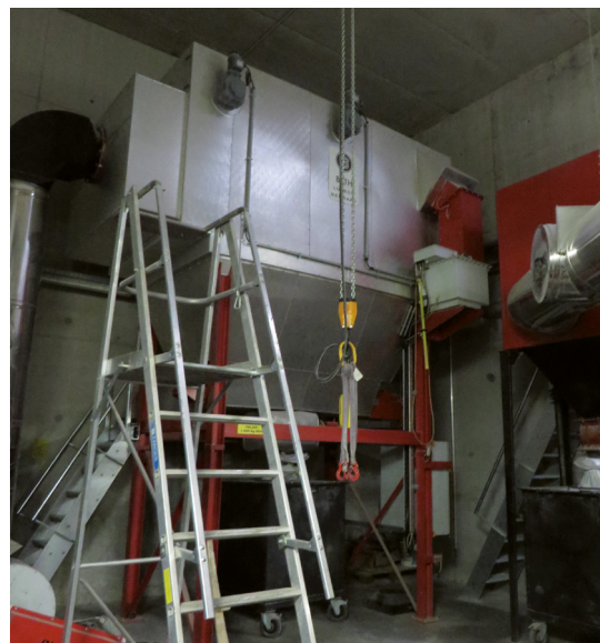
Figure 18 : Electrofiltre (Piscine Mallarmé - Besançon)
