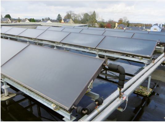
Figure 19 : Capteurs plans en toiture terrasse
