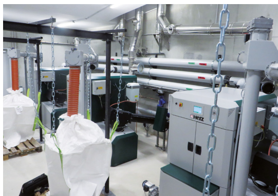
Figure 12 : Chaufferie bois avec 3 chaudières bois de puissance unitaire 150 kW - (piscine intercommunale de Morbier - 39)
