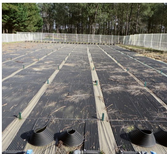
Figure 22 : Capteurs non vitrés posés à même le sol
