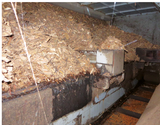
Figure 9 : Plaquettes forestières – système de transfert par convoyeur de reprise à bandes transporteuses (Centre aquatique du Pays de Morlaix-29)
