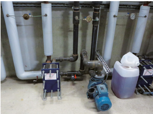
Figure 20 : Echangeur de chaleur solaire
