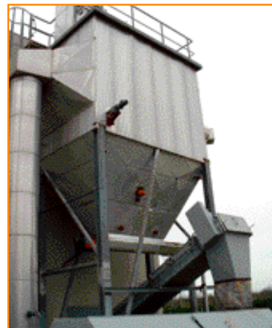
Electrofiltre (chaufferie Bois de Calais, Pas-de-Calais - 4 MW).
