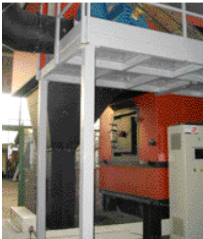
La chaudière bois du site de Boisset-les-Montrond
