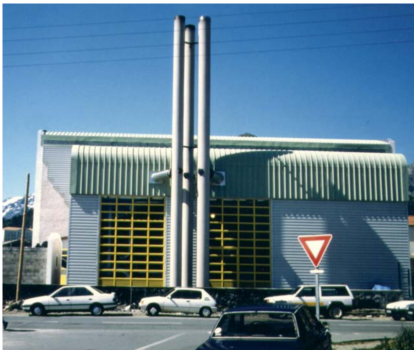
Chaufferie bois de Corte (photo Zreu).
