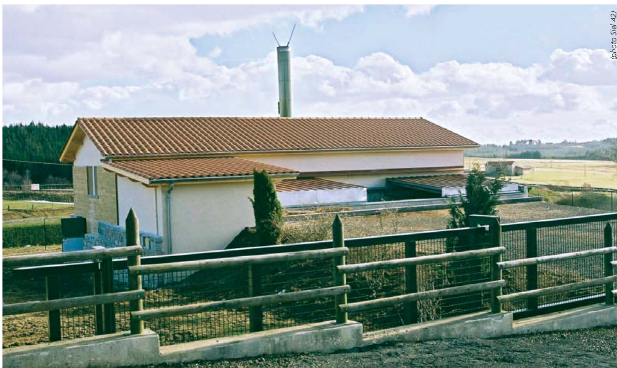
La chaufferie bois d'Usson-en-Forez (800 kW bois)
