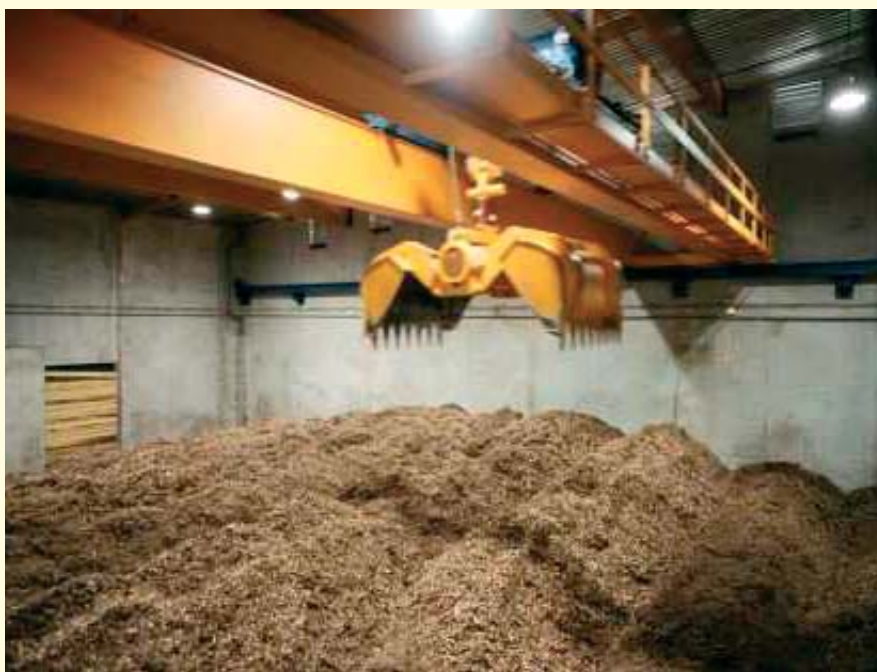
Pont roulant et grappin de la chaufferie bois de Vénissieux.
