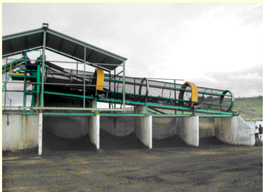
Crible à poste fixe.
