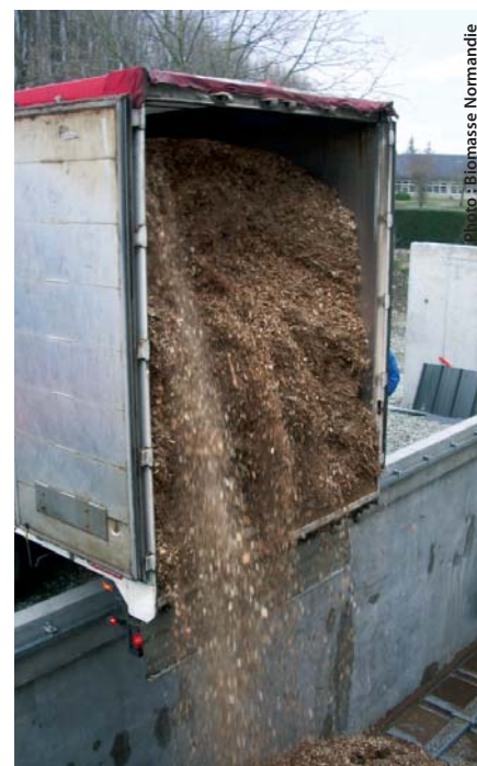
Livraison de combustible dans le silo d'une chaufferie bois.
