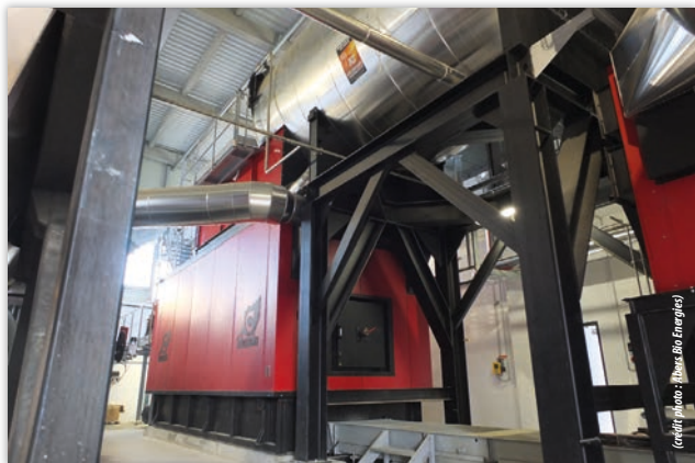
Chaudière bois de l'industrie Sill à Plouvien (Finistère).
