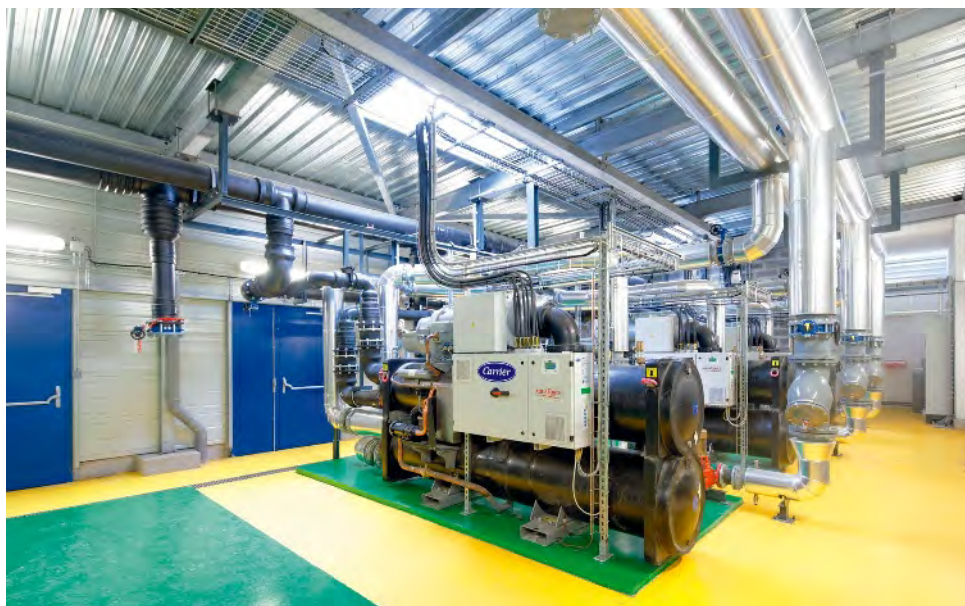
Pompes à chaleur permettant la récupération d'énergie sur les eaux traitées de la station d'épuration – réseau de chaleur de la Liane à Boulogne-sur-Mer. Dalkia
