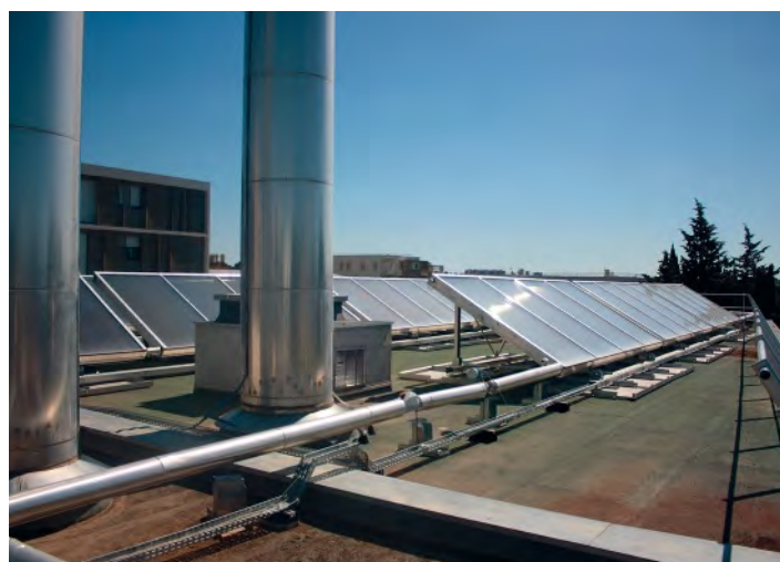
Panneaux solaires sur le toit de la chaufferie bois / gaz du réseau de chaleur de Juvignac. Engie Solutions
