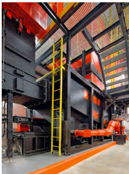
Chaudière bois (3,5 MW) du réseau de chaleur du Chemin Vert à Boulogne-sur-Mer. Dalkia
