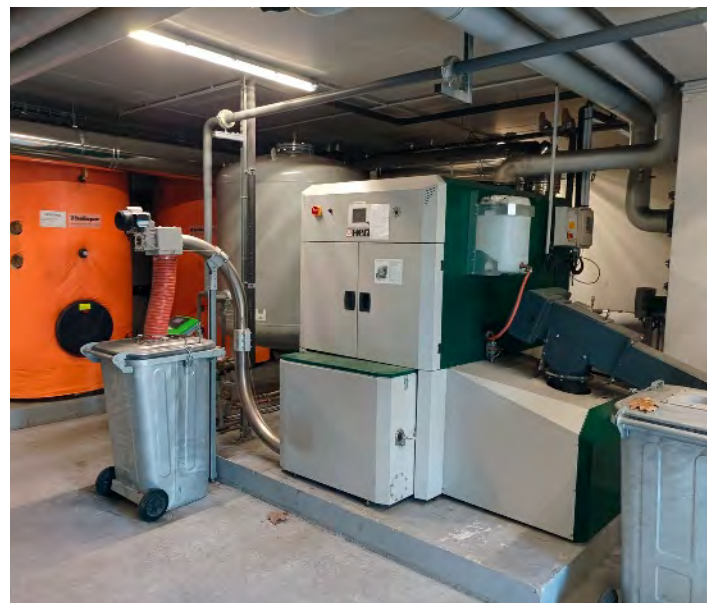
Chaudière à granulés de bois (300 kW) avec un de ses ballons tampons (en gris, à l'arrière), la benne à cendres et les ballons tampons de la pompe à chaleur pour l'eau chaude sanitaire (en orange). Lycée Honoré d'Estienne d'Orves de Carquefou
