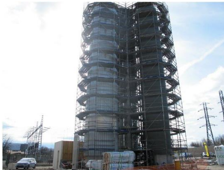
Stockage en eau surchauffée pressurisée (180°C, 22 bar) de la centrale Biomax à Grenoble
