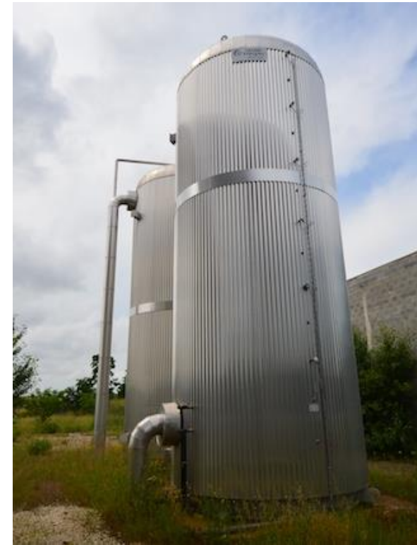
Les deux ballons de stockage d'eau chaude du réseau d'Alès photo : Frédéric Douard
