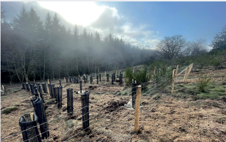
Travaux réalisés en décembre 2024 sur le pâturage communal de Solbach, dans le cadre de la démarche Trame verte et bleue. Mise en place de haies et d'arbres agroforestiers afin de recréer un effet de lisière entre l'espace forestier (ancien pâturage reboisé en douglas dans les années 1970-1980) et le pâturage communal aujourd'hui géré par un jeune agriculteur. ©Jean Sébastien Laumond
