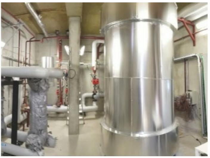
Stockage de 4m 3 Tube de 2m de haut
